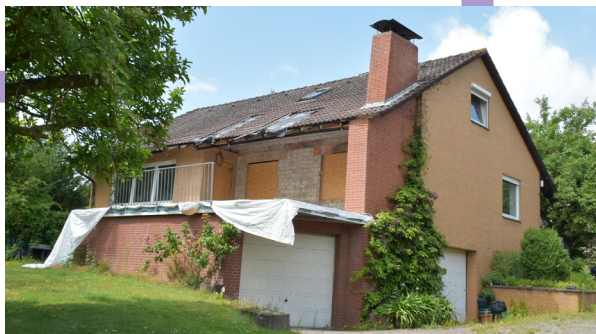
Das Haus von Bärbel Lehke ist nach dem im Januar Brand unbewohnbar.
